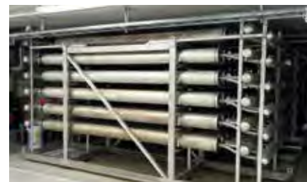
Nye filter på Hafslø vassverk.
